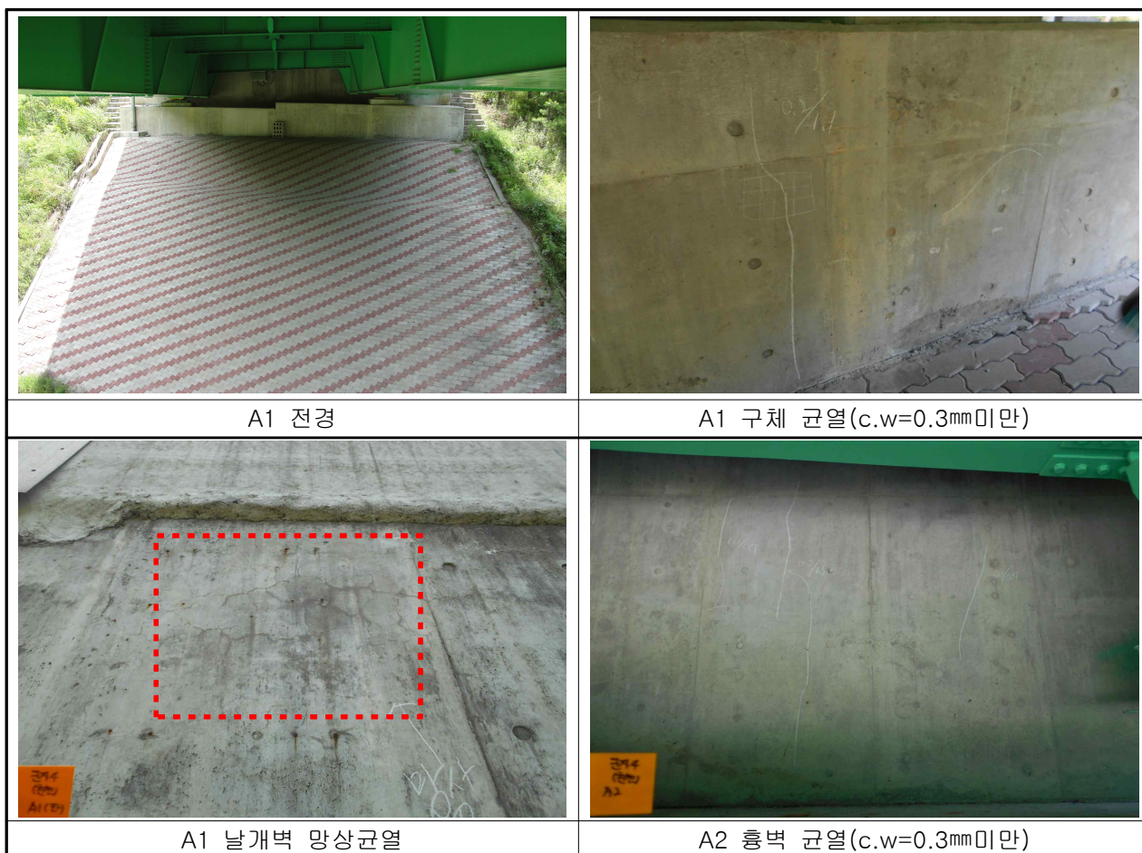
【사진 3.4】 교대 손상현황
