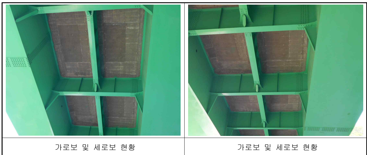
【사진 3.3】 가로보 손상현황
