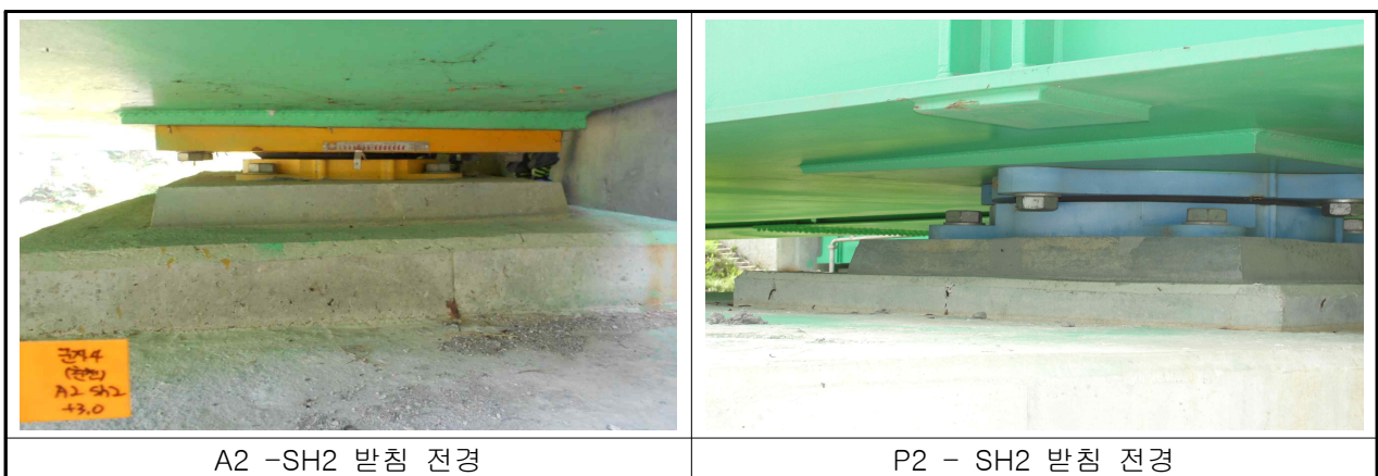
【사진 3.6】 받침장치 손상현황
