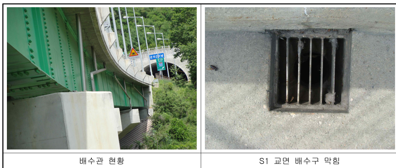
【사진 3.11】 배수시설 손상 현황
